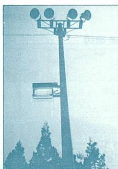
新設したグランド用の照明設備
