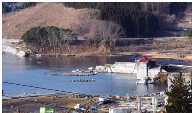
写真2：津波で崩壊した防潮堤と地盤沈下で広がった海（浦浜海岸）
